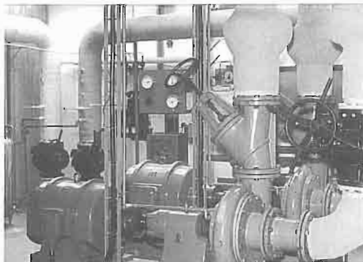
Genbrugspumper fra Hostrupsgade
